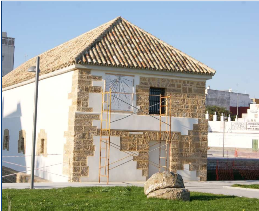
F. 2: Ejemplo de restauración (edificio del siglo XVIII) alejada de los criterios de intervención. Adición de un reloj de sol sin que haya constancia ni documentación que demostrara su existencia.
