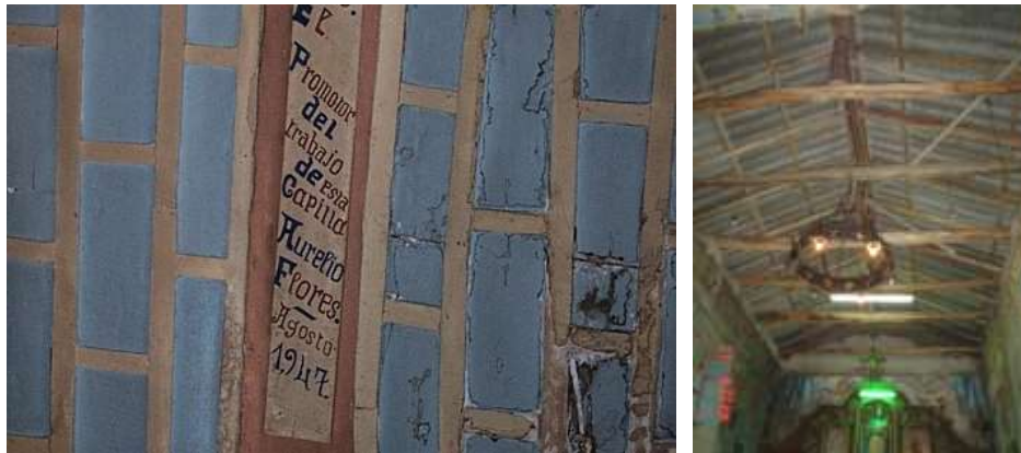
Figura 1 y 2. A la izquierda: María Cecilia Achig-Balarezo Cielo raso en la capilla con la inscripción de la posible fecha de elaboración de la pintura mural y tabular (2005) Fotografía. A la derecha: María Cecilia Achig-Balarezo La cubierta original y el cielo raso de madera fueron desmantelados produciéndose un gran faltante (2005) Fotografía.
